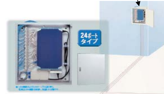
光成端盤の施工例
